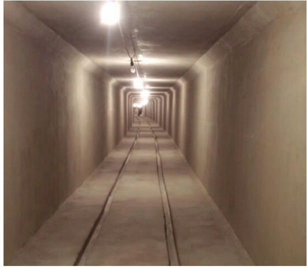
지중구조물 : 공동구, 전력구 등
